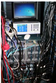
Energieverbrauchsmessung an der VDI-Testinstallation
