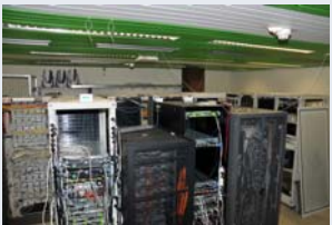
Blicke in den Serverraum des IMT
